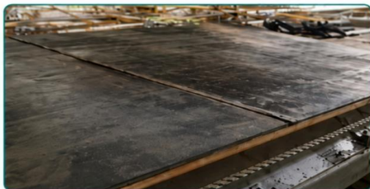
Ruptura de emenda
