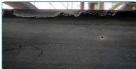
Ruptura por desalinhamento
