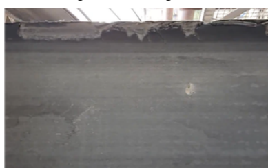
Figura 2d: rotura desalineamiento
